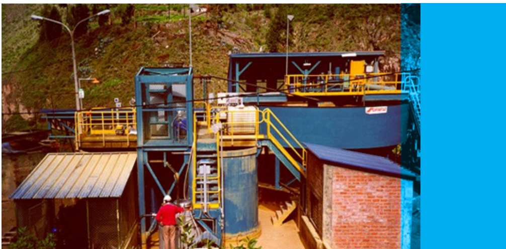
<< Planta de tratamiento de efluentes con contenido de cianuro con Caro's Acid.
